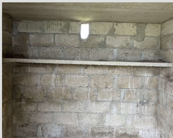
Etagère en béton, absence de fenêtre © C Chevry
